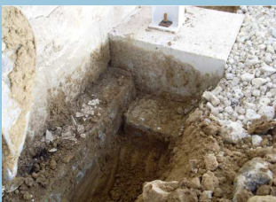
Reconnaissance de fondations à Chilly Mazarin (91) Mission : diagnostic et étude de renforcement Maître d'ouvrage : STP (Société de traitement de la presse)
