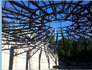
Autodrome de Linas-Monthéry (91) Bâtiment circulaire en R+2 de 38m de diamètre Mission : étude d'exécution Maître d'ouvrage: UTAC CERAM
