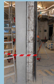
Bâtiment n°1 de SANOFI à Maison Alfort (94) Mission : étude d'exécution de renforcement Maître d'ouvrage : SANOFI
